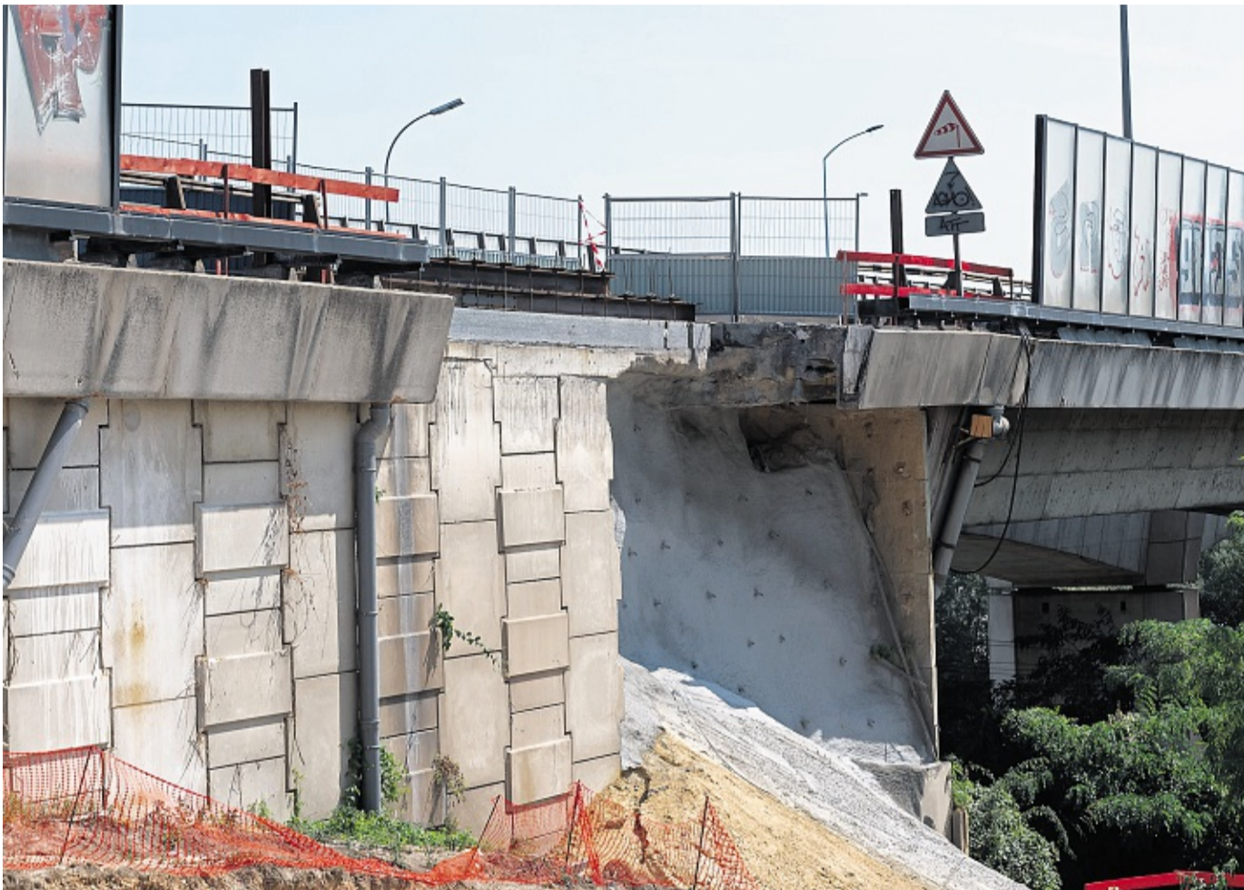
Le viaduc de Gennevilliers (Hauts-de-Seine), le 16 août, trois mois après l'affaissement d'un mur de soutènement. JACQUES WITT/SIPA
